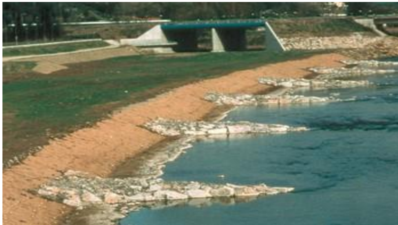
Vue de l'aménagement mixte réalisé avec épis déflecteurs en enrochements, lits de plançons en pied de berge, plantations, ensemencement et géotextiles biodégradables (avril 1998) (La Loire à Brives-Charensac )
